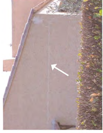
Fissuration traduisant un décollement de la structure par absence de liaisonnement entre niveau bas et combles.
