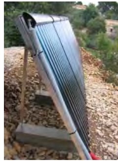
Capteurs sous-vide en complément de chauffage
