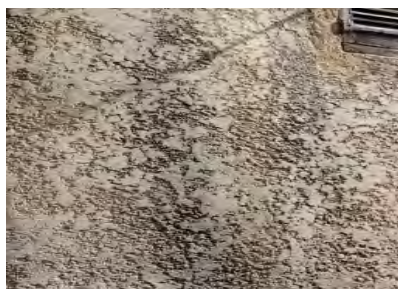
En réhabilitation comme dans le neuf, éviter les enduits projetés avec finition "écrasée", source de salissures, d'accroche des poussières et de nidation d'insectes...
