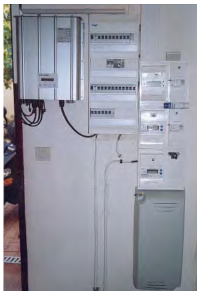
Onduleur et compteur de production
