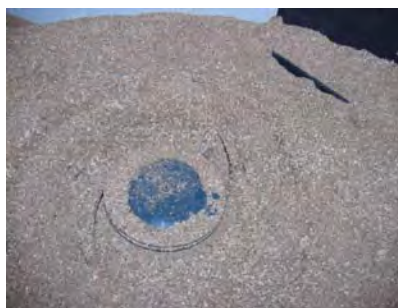
Râteau dans un silo de stockage de copeaux (plaquettes)
