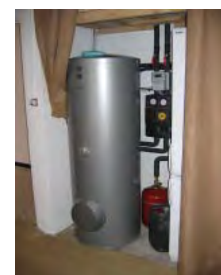
Ballon de stockage eau chaude
